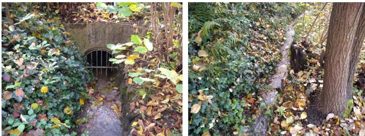
Abbildung 10: Rechen am Ende des offenen Bachabschnittes (links) stark verkrautete Ufer und Bäume im Abflussprofil (rechts)
